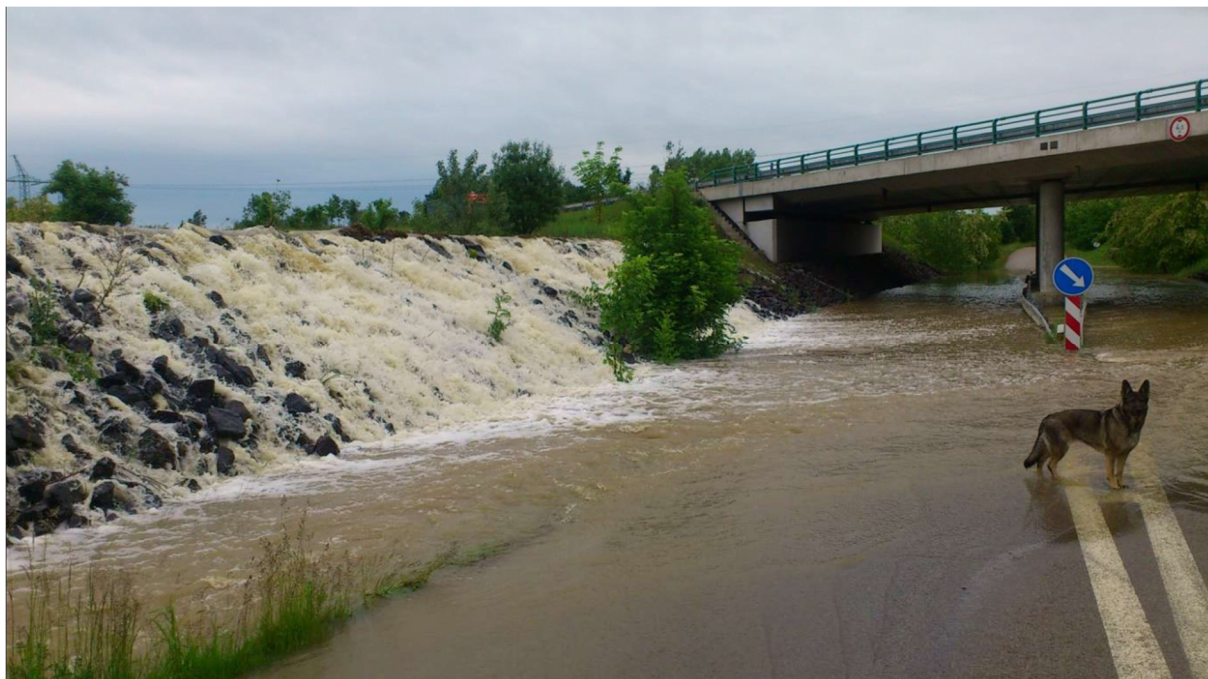
Obrázek 10 – Přelití protipovodňové hráze most D8-18 (zdroj: obec Všestudy)
